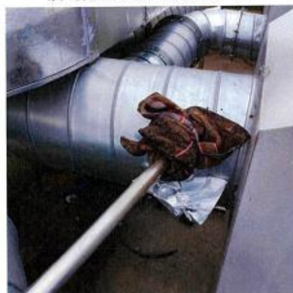
废气设施处理前 (DA004) ⊙
