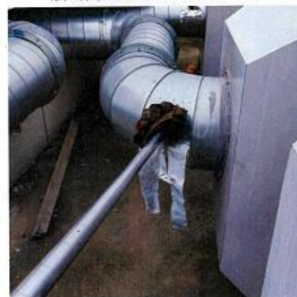
废气设施处理前 (DA005) ⊙
