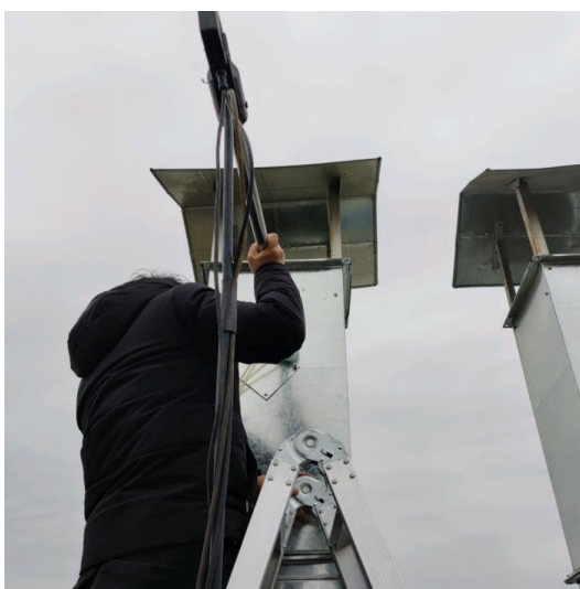
废气设施处理后 (DA006) ©
