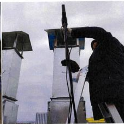
废气设施处理后 (DA003) ⊙
