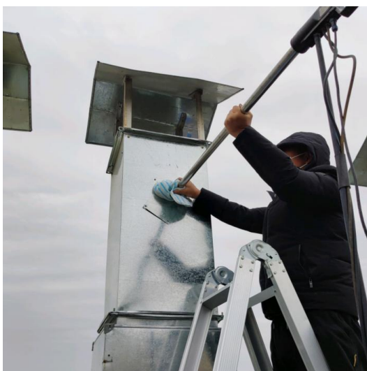
废气设施处理后 (DA005) ©
