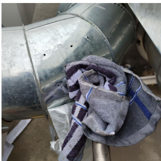
废气设施处理前 (DA003) ©
