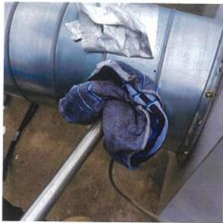
废气设施处理前 (DA006) ⊙
