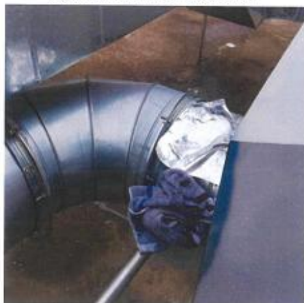
废气设施处理前 (DA002) ②
