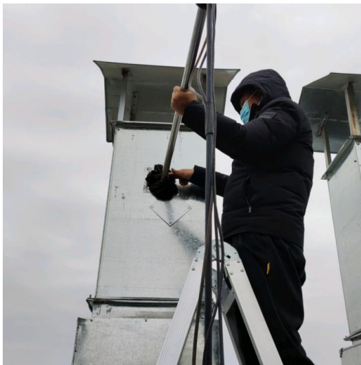
废气设施处理后 (DA004) ©
