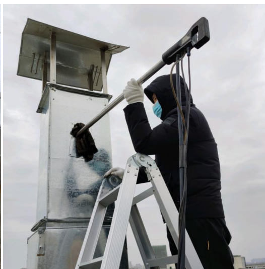
废气设施处理后 (DA001) ©
