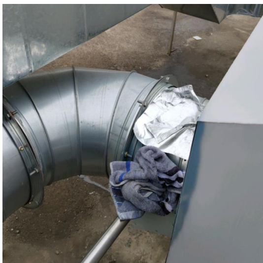
废气设施处理前 (DA002) ©
